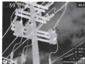
ภาพที่ 1 ก่อนการแก้ไข (ภาพถ่ายความร้อน)
